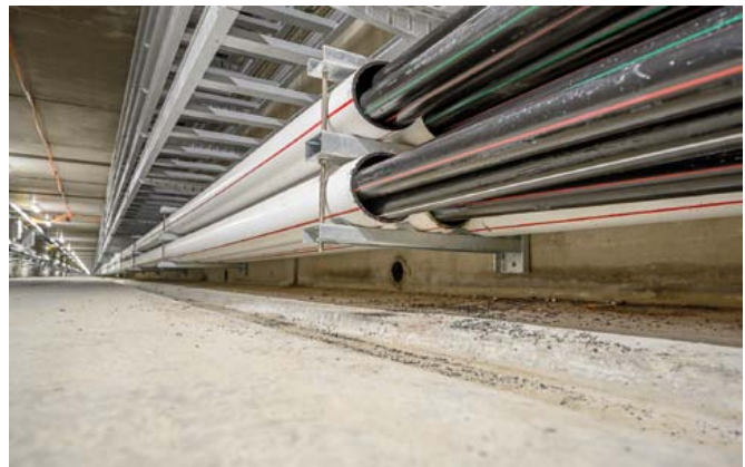
Kabelschutzrohre mit eingezogenen Multirohren für das Einblasen von Glasfaserkabeln.
