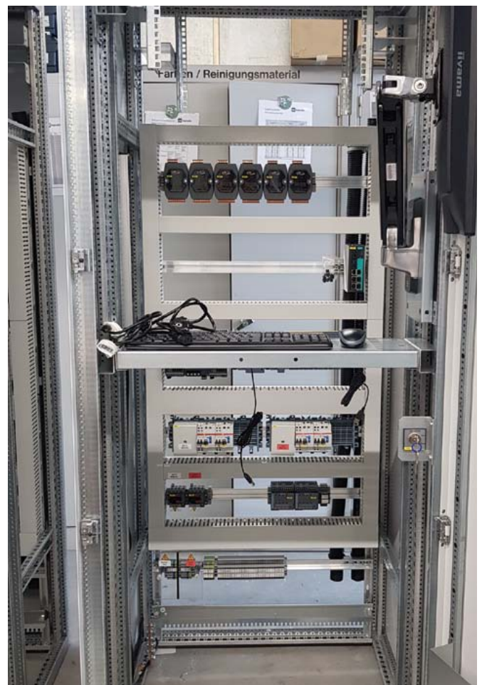
Für die Werksprüfung werden die Schaltschrankaufbauten für die Lüftungssteuerung aufgebaut und miteinander verkabelt.
