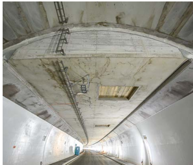
Entlang des Trassees für die Kabelverlegung der Tunnelbeleuchtung sorgen künftig 750 LED-Leuchten für eine perfekte Ausleuchtung des Tunnelinnern.
