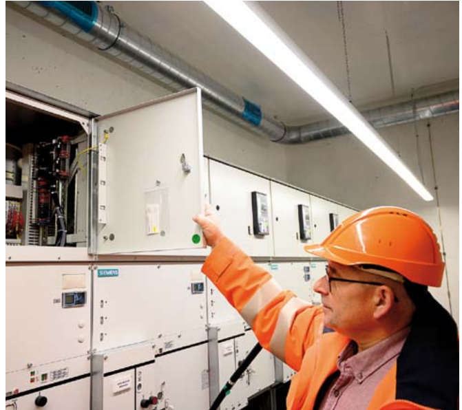
Mittelspannungsschaltanlage (16 kV) mit geöffnetem Steuerabteil.
