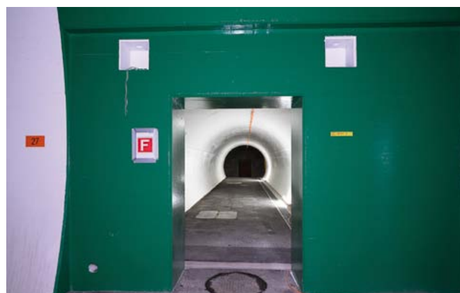
Besonders wichtig im Notfall: Die hell beleuchteten Querschläge, welche die Tunnelröhren verbinden und so einen sicheren Fluchtweg gewährleisten.
