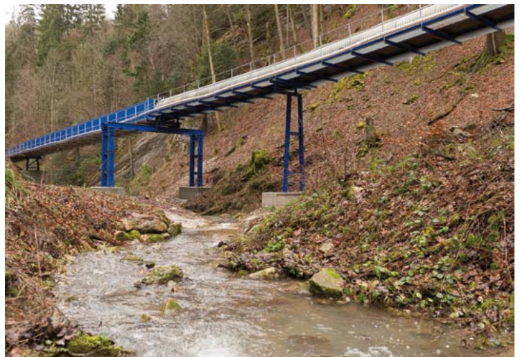
Das 1100 Meter lange Förderband für den Abtransport des Ausbruchmaterials in die Deponie Fasiswald ersetzt umweltbelastende Lastwagenkonvois.
