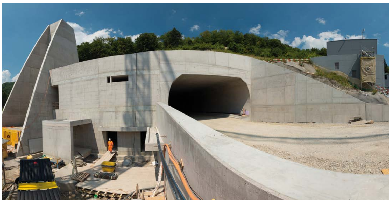
Eine der zwei Portalzentralen. Sie dient als technischer Knotenpunkt des Belchen Sanierungsprojektes.
